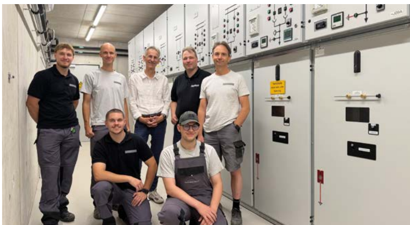
Gemeinsam für ein starkes Stromnetz: Abteilungsleiter Bernhard Kiening (Mitte) und sein Team in der neuen Schaltanlage
